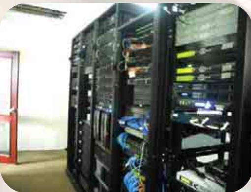
Hệ thống máy chủ, lưu trữ trung tâm tại kênh truyền hình - VOV
